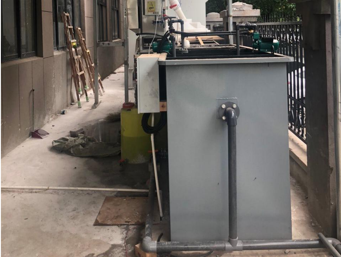
图 4-2 废水处理设施图
