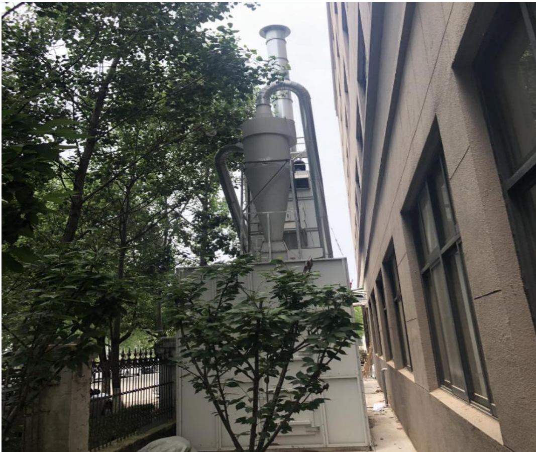
图 4-4 本项目木质板材加工粉尘处理设施图
