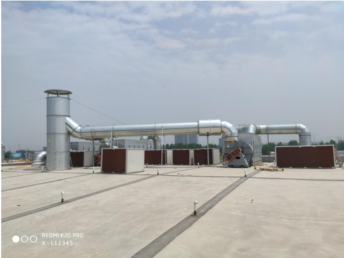
图 4-5 本项目面漆废气处理设施图
