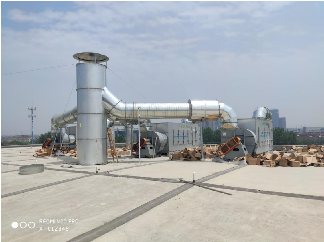
图 4-6 本项目底漆废气处理设施图
