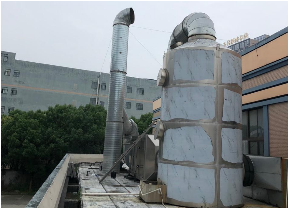
图 4-8 本项目老车间喷漆废气处理设施图
