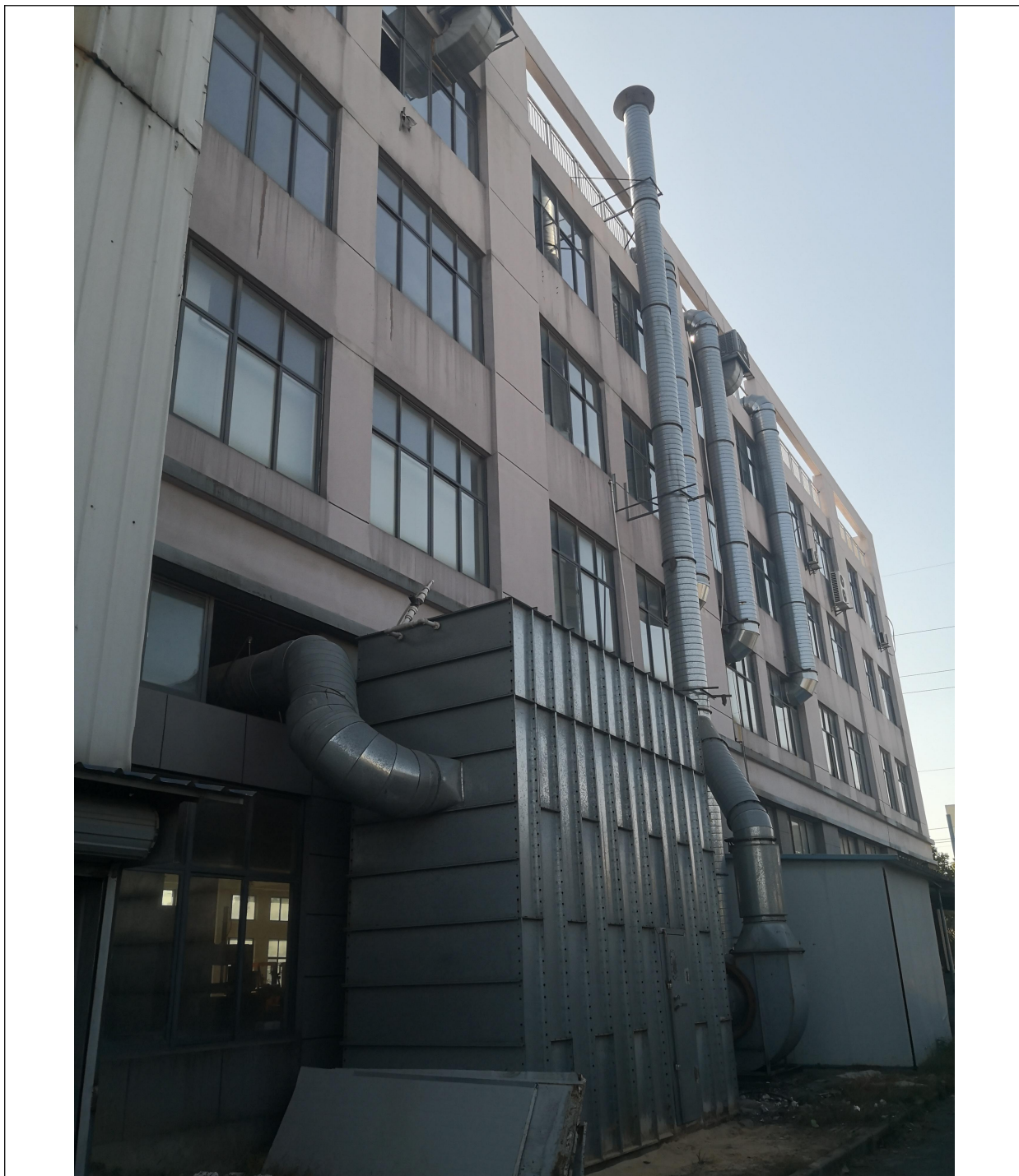
图 4-3 废气处理设施图
